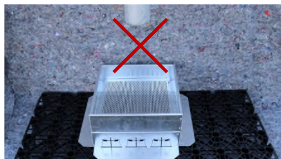
Abbildung 3: Montagefehler - Fallrohr oberhalb des Einleitelementes
