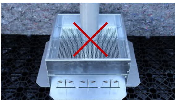
Abbildung 2: Montagefehler - Fallrohr steht auf dem Lochblech auf
